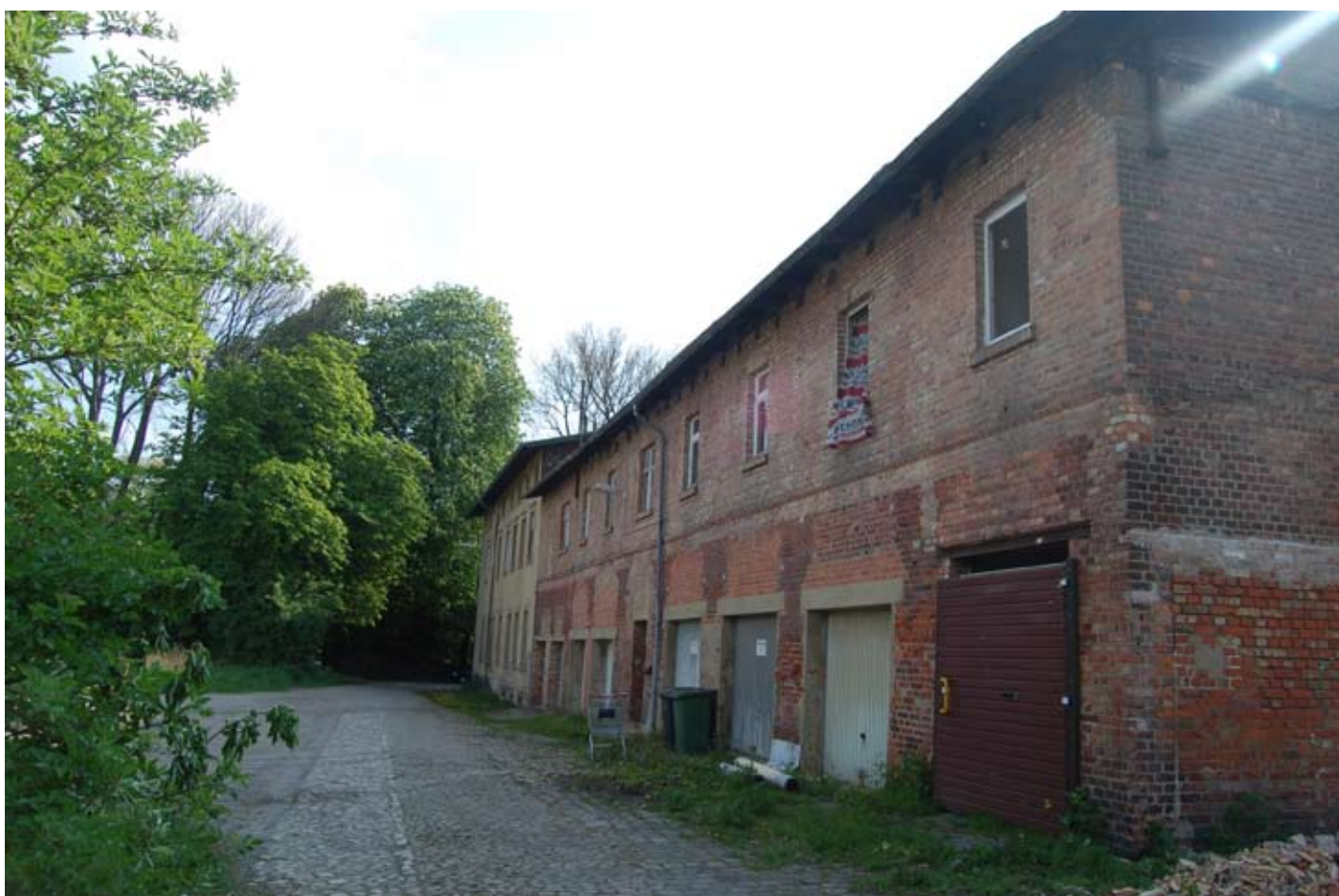
Oben: Kaputter Windfang im Eingangsbereich. Unten: Rückseite des Lagers, Blickrichtung Tagebau.
