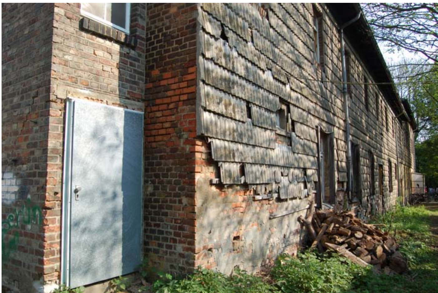
Oben und Unten: Zustand der Fassade der Vorderseite des Lagers.
